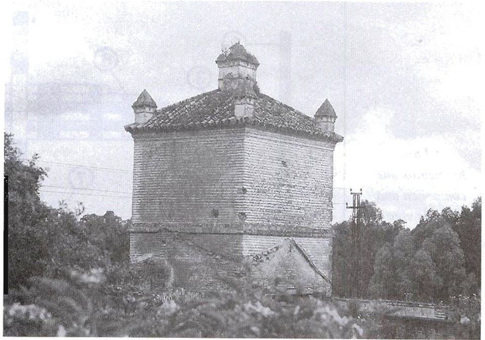
Foto 3.- Torre de contrapeso del molino de aceite del monasterio de La Cartuja de Jerez.
